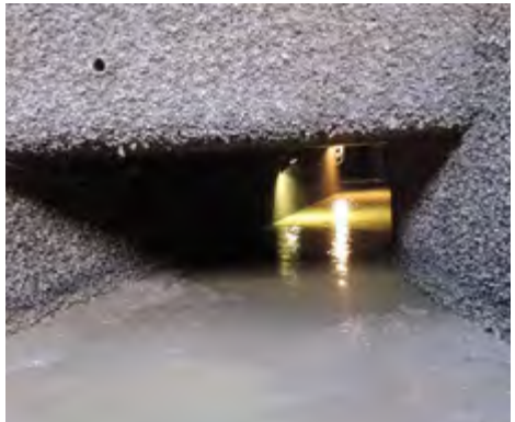
Aangroei van quaggamosselen op een duiker. Vooral in duikers en leidingen is het lastig om de mosselen te verwijderen. Dit kan tot hoge kosten leiden.
